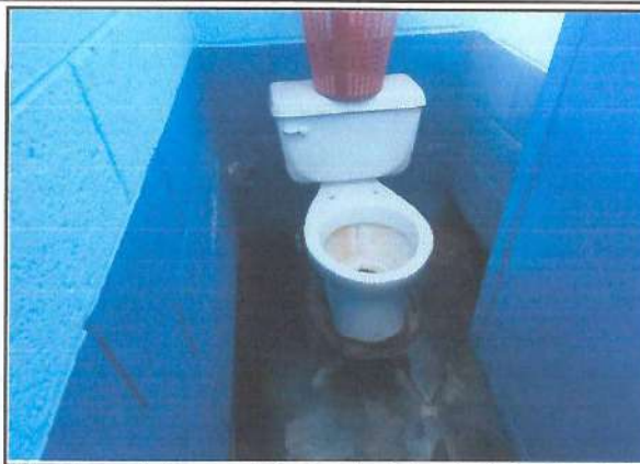
Foto 2: Los sanitarios se encuentran en mal estado, se hará el cambio total de los mismos.
